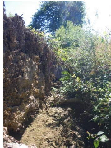
Berges du cours d'eau détruites
